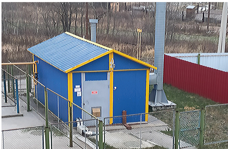
Рис. 19. Автономный тепловой пункт.
